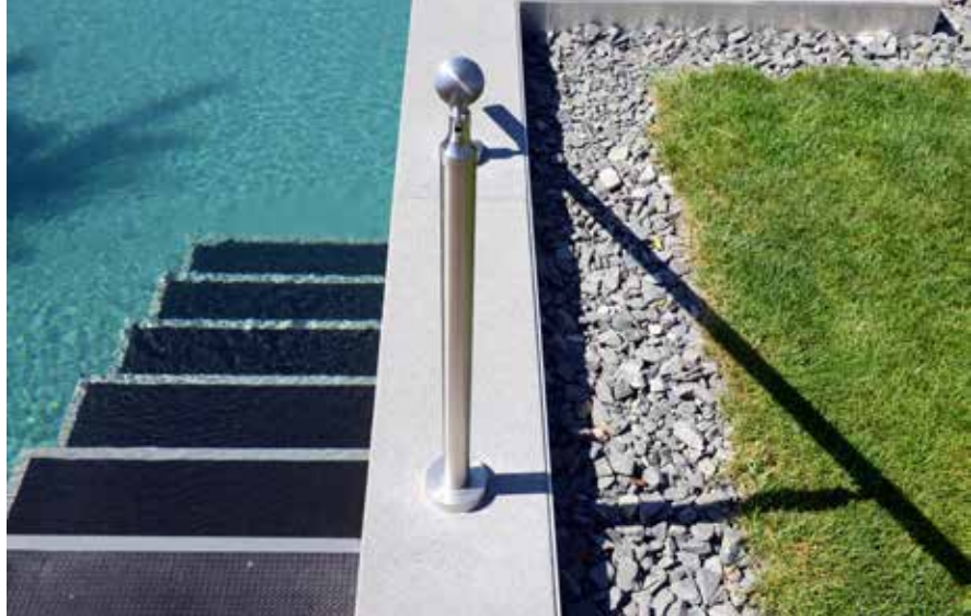
▲ Damit man bei rechtzeitiger Vorsicht später nicht das Nachsehen haben muss, ist hier zum Geländer auch die rutschfeste Folie auf den Stufen gekommen.
